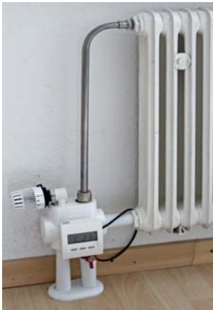
Der Funk-Rücklauftemperaturregler von Thermozyklus ist auf dem Einrohrhahnblock installiert. Die Vorlauftemperatur im Einrohrhahn wird am ersten Heizkörper im Ring erfasst.
