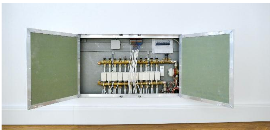
Durch die Verwendung von stromsparenden Stellventilen mit elektromotorischem Antrieb können diese über die 18-Volt-Bus-Leitung mit Strom versorgt werden. Trotz hoher Rechenleistung der Zentralgeräte ist der Eigenstromverbrauch des Thermozyklus-Systems gering.
